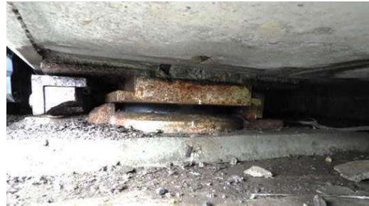
支承サイドブロックの破断
