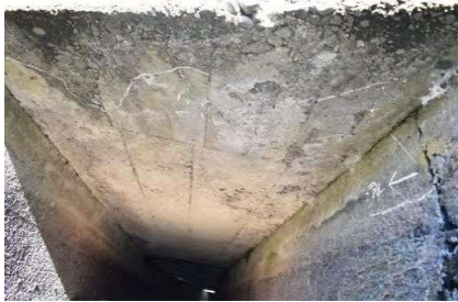
床版下面の剥離
