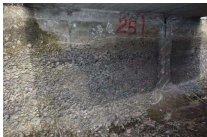
下部工の欠損 (浸食)
