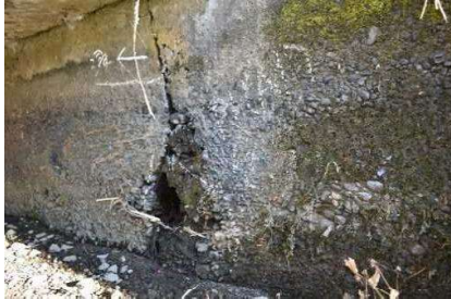
下部工の欠損 (浸食)
