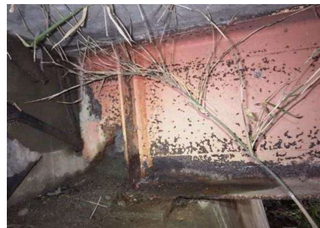
主桁端部の腐食(板厚減少)
